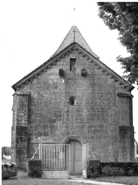
Fig. 33 : vue des vestiges du système de défense de l'entrée de l'église de Boussenois (21).
