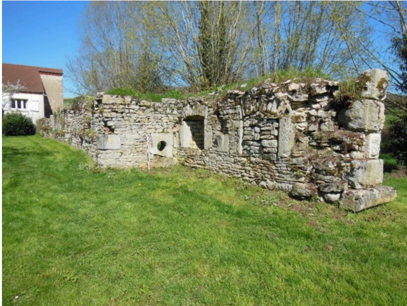
Cliché 2 – Etat de la courtine à cordon d'escarpe avant restauration, vue de l'intérieur.
