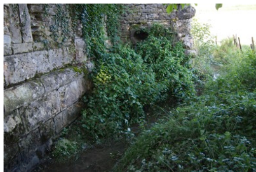
Cliché 1 – Etat de la courtine à cordon d'escarpe, vue de l'extérieur.
