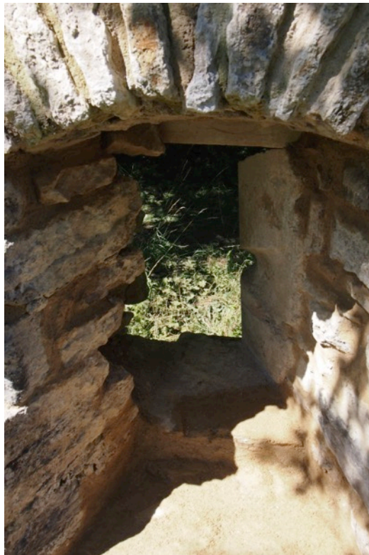
Cliché 6 – Les côtés et le voûtement de l'une des niches qui viennent d'être jointoyés.
