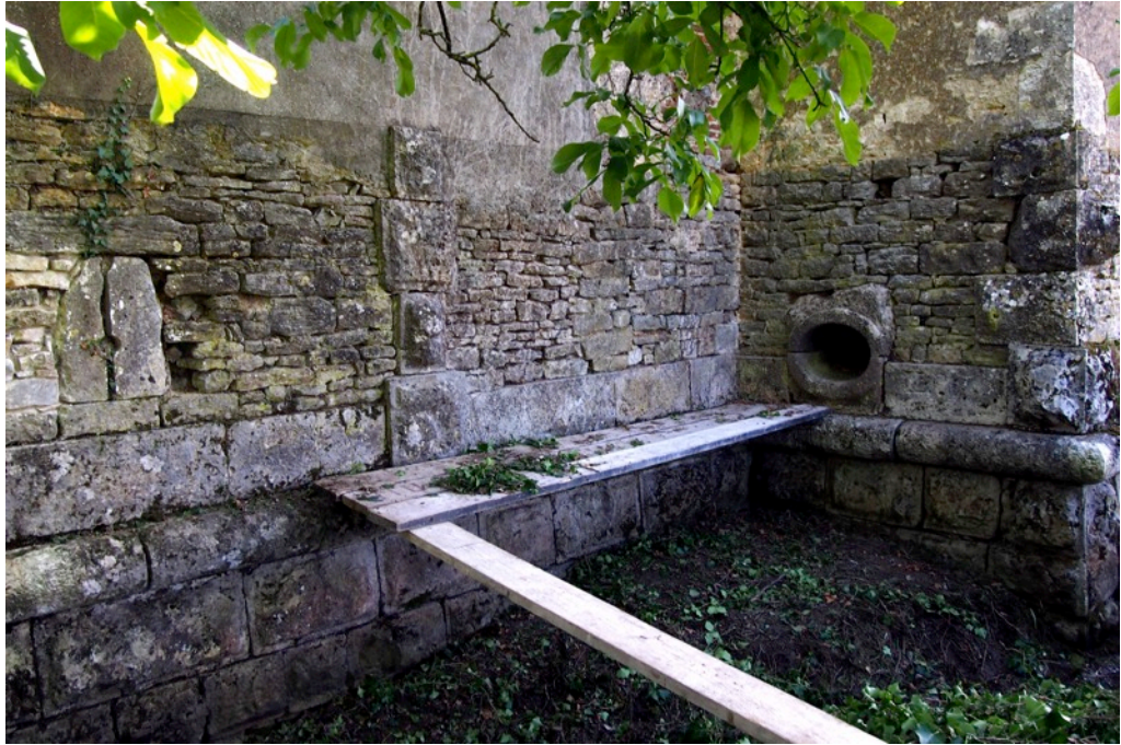
Cliché 2 – Dégénéralisation en cours de l'extérieur de la courtine
